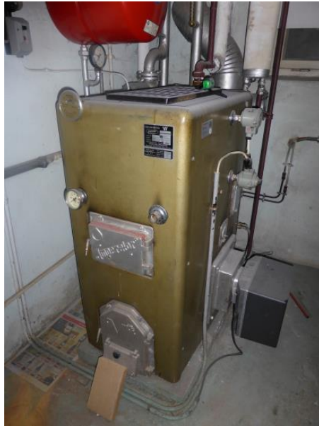
Quelle: Energieberatungszentrum Stuttgart
