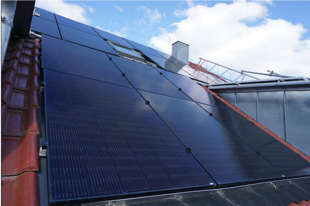
Quelle: Energieberatungszentrum Stuttgart
