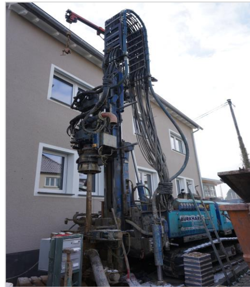
Quelle: Energieberatungszentrum Stuttgart
