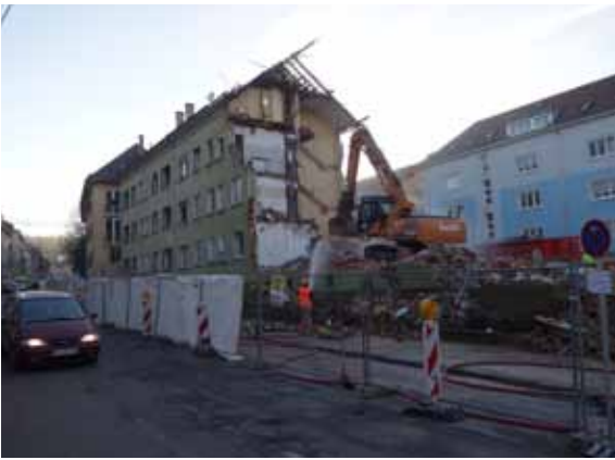
Der Abriss der Gebäude Klingenstrasse 101-105. Hier entsteht derzeit der Neubau des Bau- und Wohnungsverein Stuttgart e.V. mit potenziellem Stadtteilzentrum für Gablenberg.
